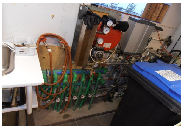
Kontrollrommet er i garasjen.
