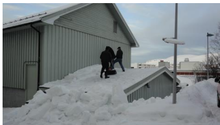
Som man ser, så var det betydelige snømengder som ble fjernet fra taket, spesielt på den andre siden.
