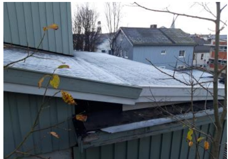
Nytt tak holder forhåpentligvis vannet
