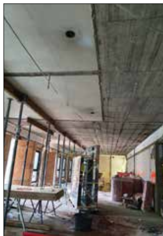
Slik så selskaplokalene ut etter vannlekkasjen Foto: Tormod Sveli.
